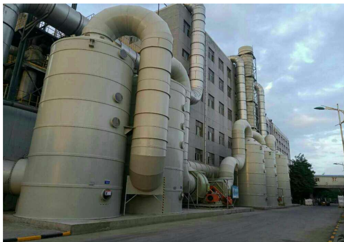
氨基酸生产二部成品二车间异味治理后设施
