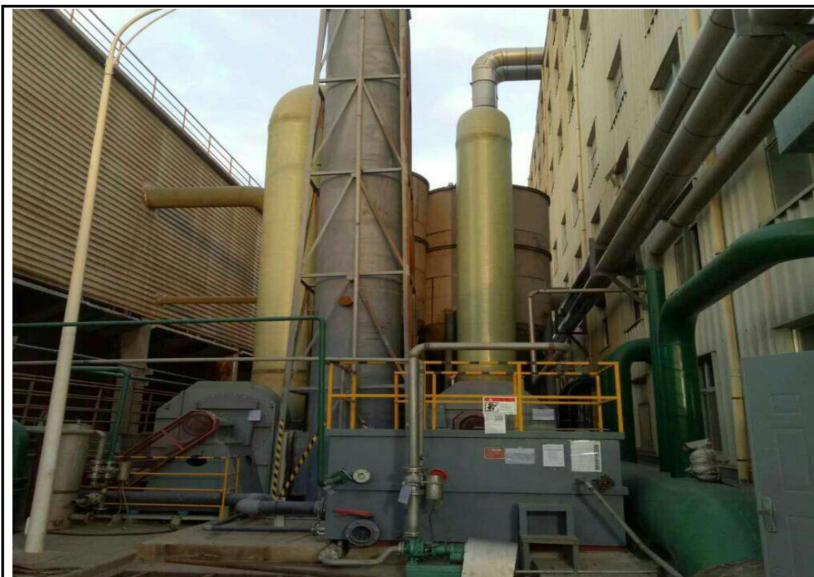
氨基酸生产二部发酵三车间异味治理后设施
