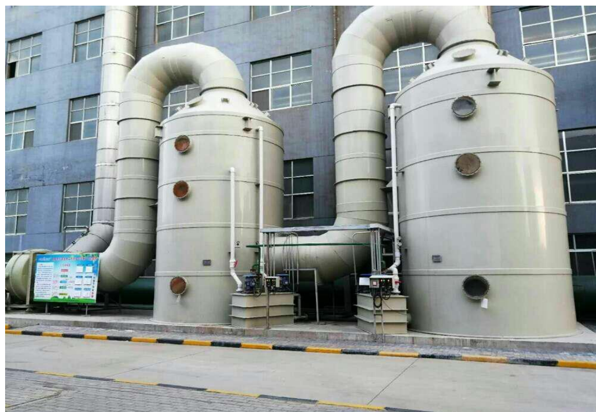
味精生产二部发酵二车间异味治理后设施
