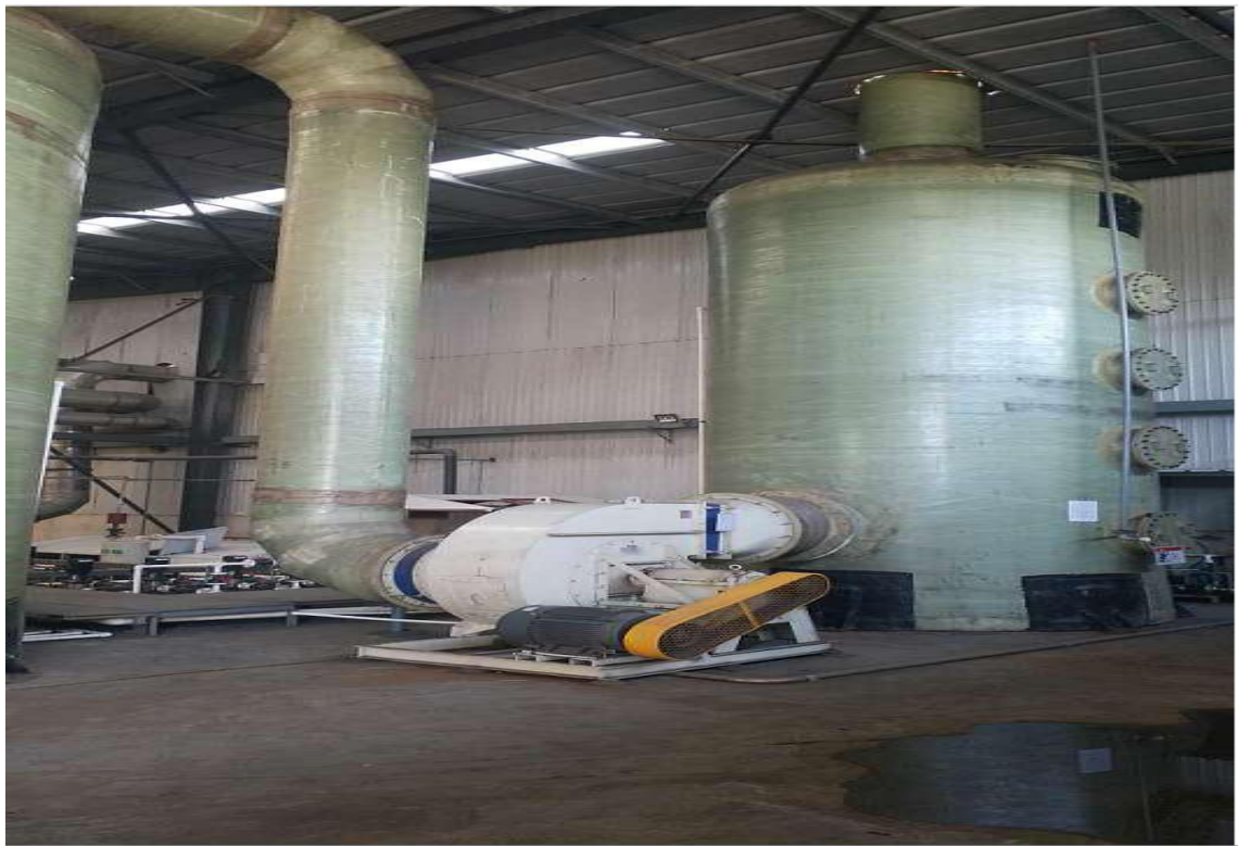
氨基酸生产一部成品三车间异味治理后设施
