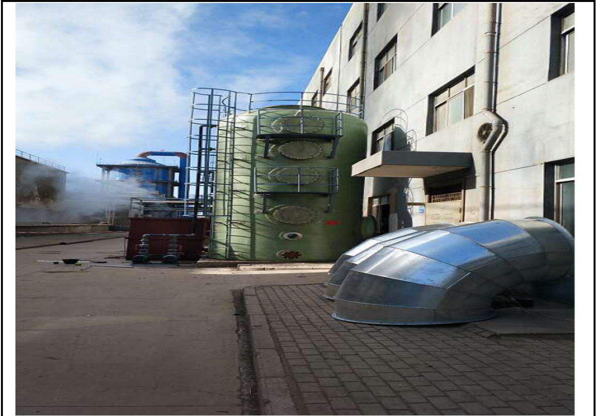
氨基酸生产一部成品二车间异味治理设施
